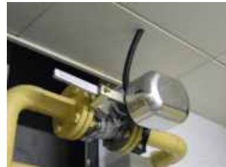
▲ 가스누설경보기의 차단밸브가 설치된 사례
