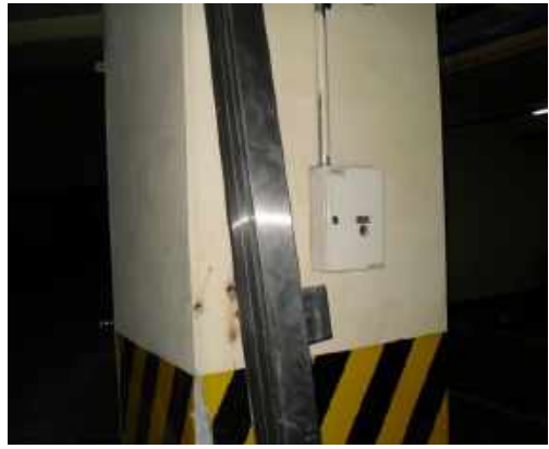
▲ 방화셔터 레일이 파손된 상태로 방치한 경우
