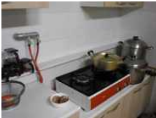
▲ 가스누설경보기가 미설치된 경우
