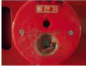
▲ 발신기의 파손을 방치한 경우
