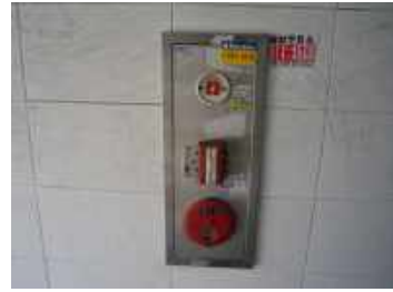
▲ 위치표시등의 파손을 방치한 경우
