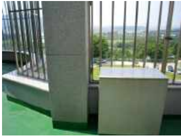
▲ 구조대 설치장소에 창살과 시건 장치로 사용이 제한되는 경우
