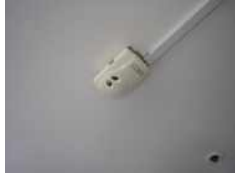
▲ 가스누설경보기의 탐지부가 설치된 사례
