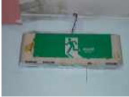
▲ 유도등이 부식되어 점등되지 않는 경우
