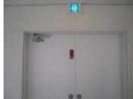
▲ 피난구 유도등이 올바르게 설치된 경우
