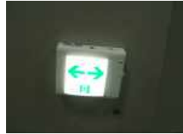
▲ 통로유도등이 올바르게 설치된 경우
