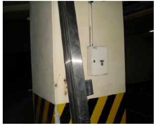
▲ 방화셔터 레일이 파손된 상태로 방치한 경우
