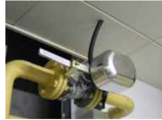
▲ 가스누설경보기의 차단밸브가 설치된 사례
