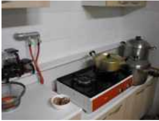
▲ 가스누설경보기가 미설치된 경우
