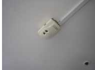
▲ 가스누설경보기의 탐지부가 설치된 사례
